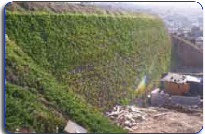
Ejemplo de muro de retención hecho de llantas enteras. Foto cortesía de la Comisión Estatal de Servicios Públicos de Tecate
